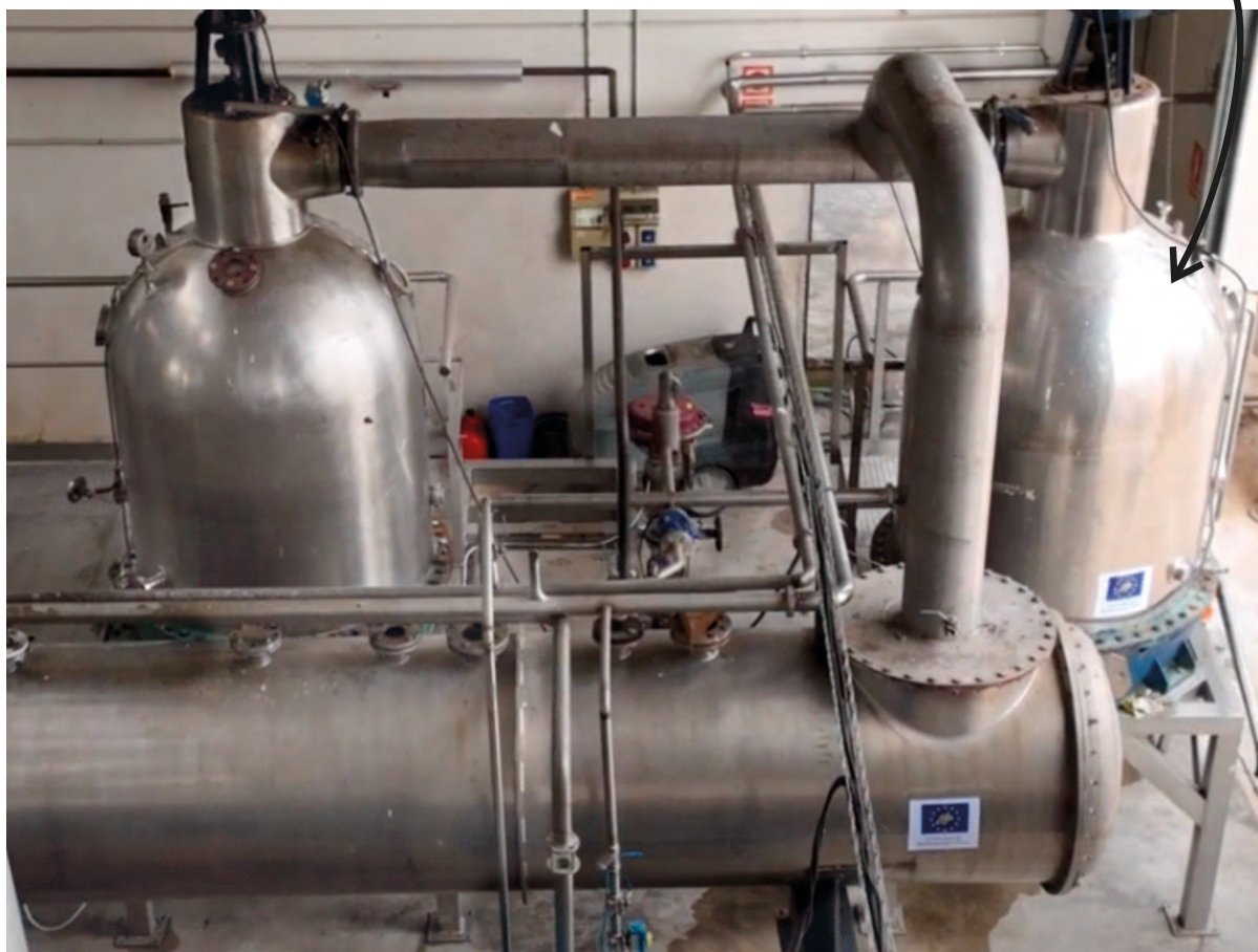
Unidad 2 de concentración de 2 m 3 .
